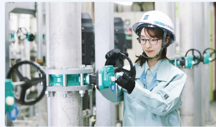
機械室で日常の巡視点検。
