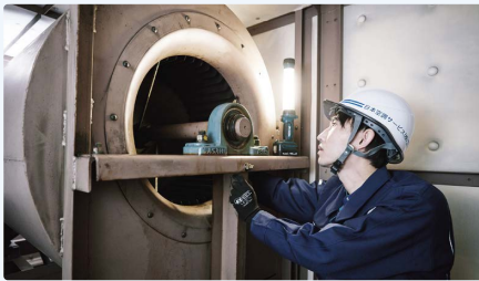
大規模施設では扱う設備も大型に。
