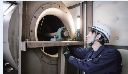
大規模施設では扱う設備も大型に。
