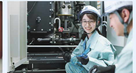
ボイラーの日常点検・運転状態の確認。
